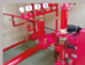
PROJETOS E OBRAS DE COMBATE A INCÊNDIO
