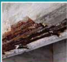
CORROSÃO NO CONCRETO ARMADO
