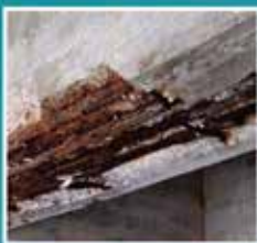
CORROSÃO NO CONCRETO ARMADO
