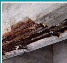
CORROSÃO NO CONCRETO ARMADO
