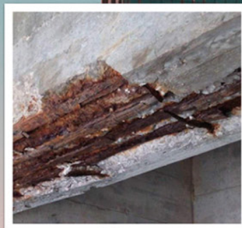
CORROSAO NO CONCRETO ARMADO
